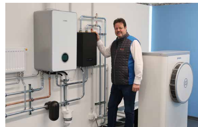
Hybridanlage in einem Schulungsraum. Rechts die Luftwärmepumpe, welche vor dem Haus steht. Nicht im Sichtfeld links, der Speicher für das Warmwasser. Foto: Lutz Lochau
